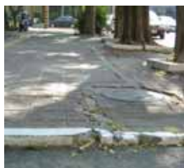
圖 17.地磚破裂尚未修補
